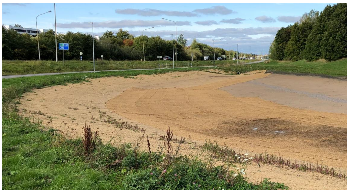
Figur 15 – Exempel på större torrdamm - dagvattenhantering för bostadsområde Skogsvallen i Linköping (Boberg 2020). Damm utförd med dränering i dammbotten samt erosionsskydd av typ kokosnät.
