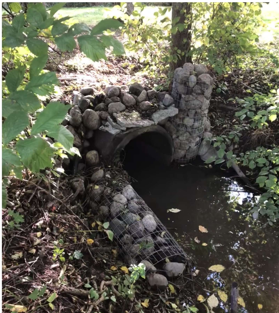
Figur 8 Mynningen av 1000-ledningen till dagvattendiket.
